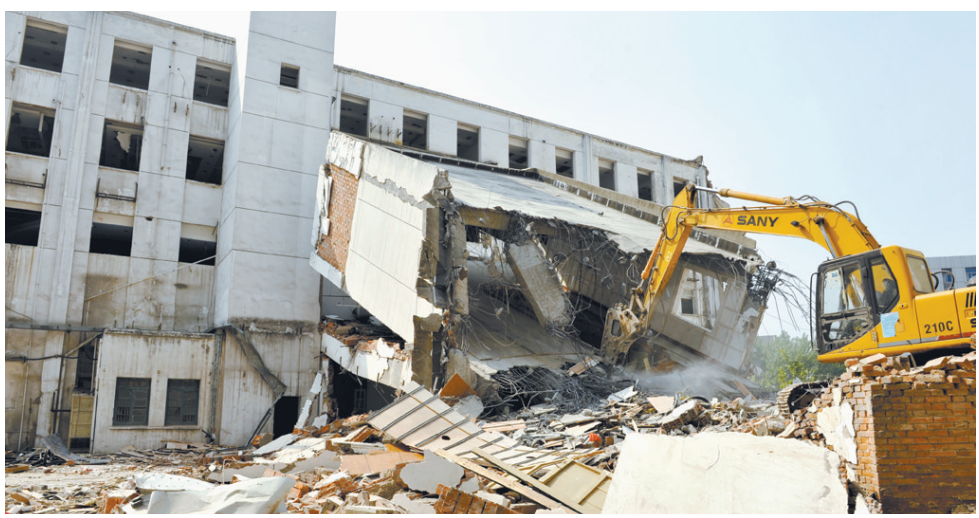
28日,合肥市四牌楼新华书店楼体拆除工程日前全面展开,60天完成两栋楼的拆除及垃圾清运和场地平整工作。新华书店一直是四牌楼的标志性建筑,全省最大的书店纪录保持了42年,两年后一座30多层的大楼将在原址上建成,下面五层全是书店,总面积达到一万多平方米。倪路/摄
