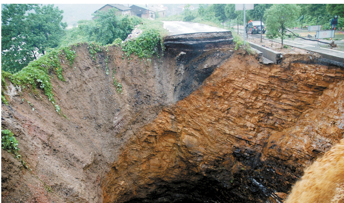
6月19日,受强降雨影响,当日凌晨起,浙江221省道江山市境内大陈岭路段右幅车道开始坍塌,形成一个长约20米、宽约15米、深30米的大洞。
