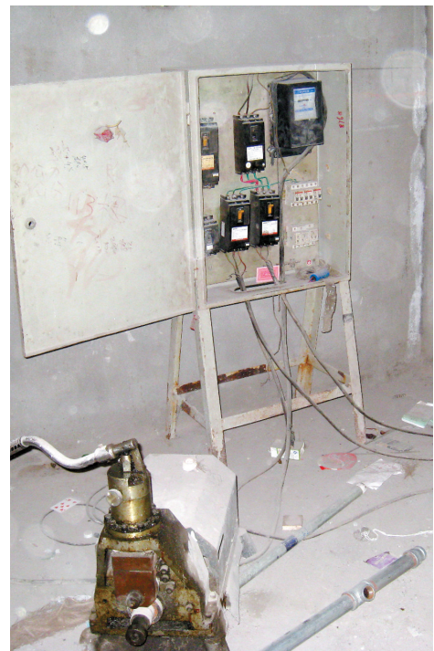
施工现场 用电不规范
