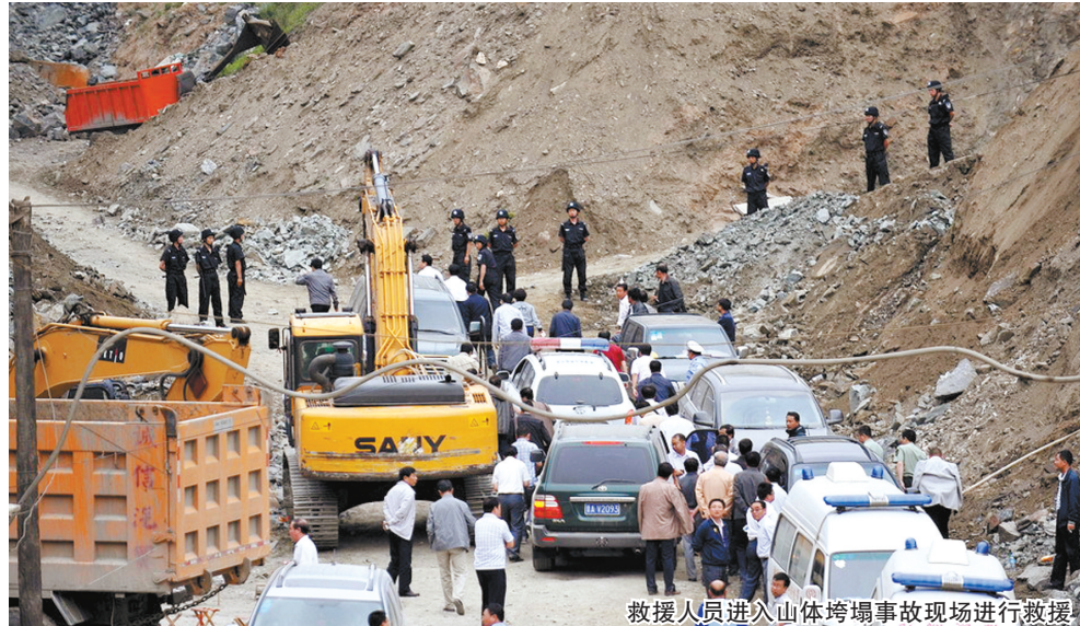
救援人员进入山体垮塌事故现场进行救援
