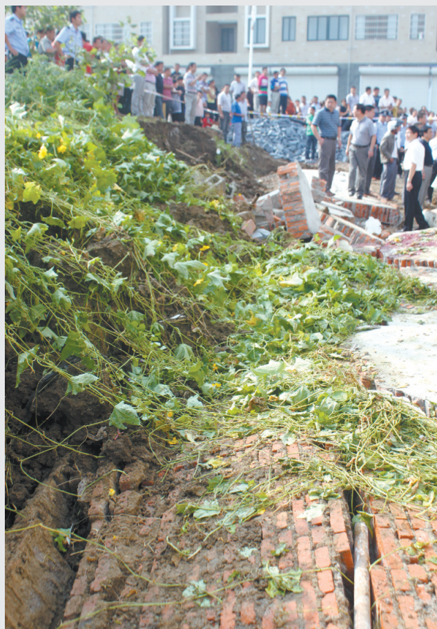
围墙坍塌现场
