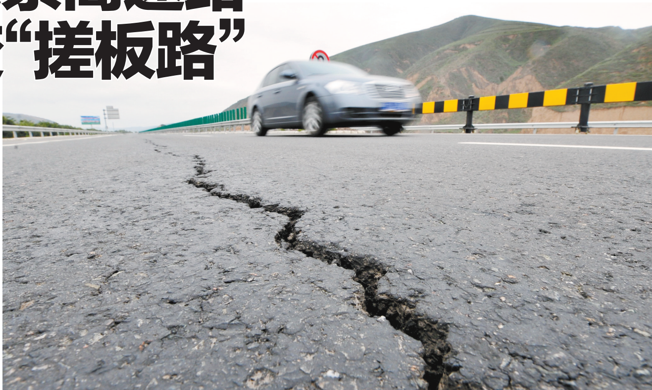
一辆汽车从出现裂缝的路面上驶过
