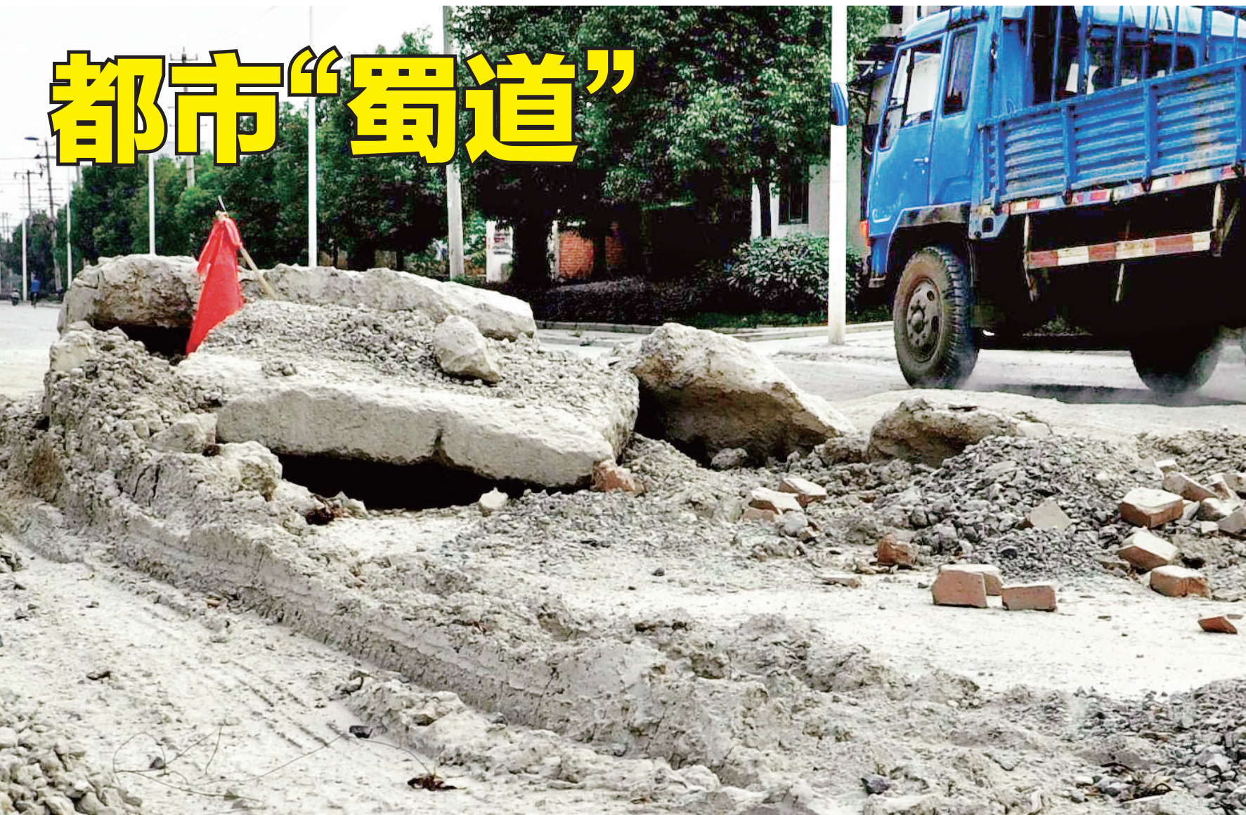
“晴天扬尘雨天泥,一路颠簸众人怨。”位于合肥市庐阳区大杨产业园的新柏路路面破损严重,记者在现场看到,这条路车流量较大,其中不少是重型货车。严重破损的路面上,分布着大小不一的坑坑洼洼,最深处落差达到20厘米。车辆驶过时,扬起大量尘土,过往路人纷纷捂住鼻子,现场灰蒙蒙一片。路两边的绿化带披上厚厚一层灰。 记者 倪路/图
