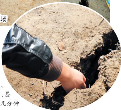
塌陷点北侧路面出现巨大裂痕
