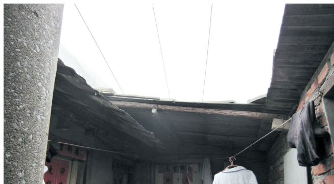
烧伤李新路的高压线与楼顶相距甚近
