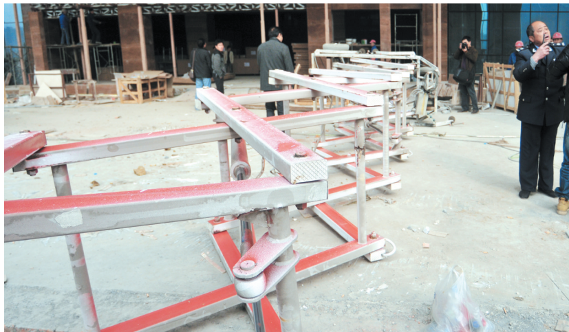
现场升降机倒塌
