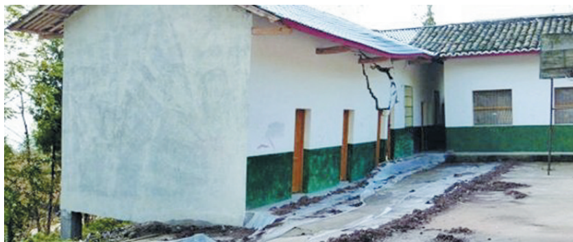
学校地势下沉,墙体严重倾斜、撕裂
