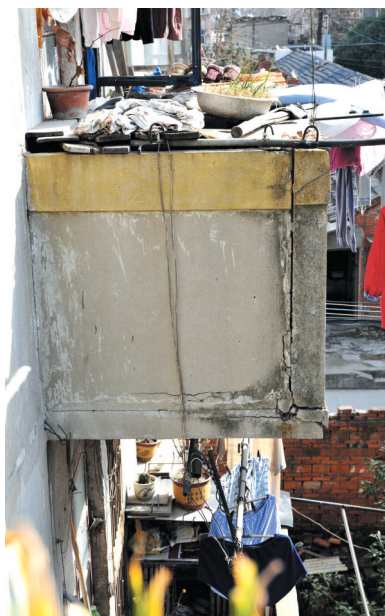
开裂下沉的阳台
