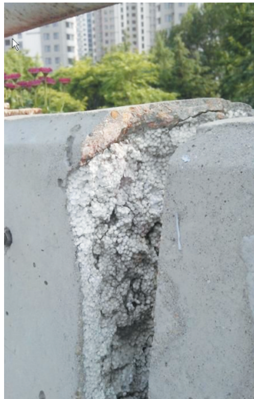
裂缝处露出泡沫填充物(网络图片)
