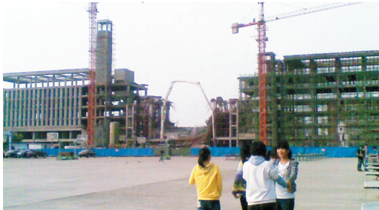
图书馆大楼倒塌现场
