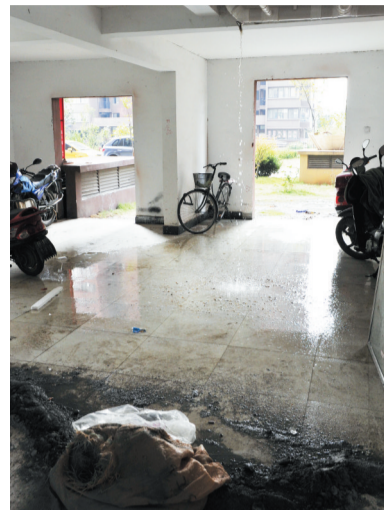
“交房时下水是通的，现在堵住不是我们的责任。”据开发商现场负责人沈助理介绍，他们已经维修过5次，眼下很无奈。
