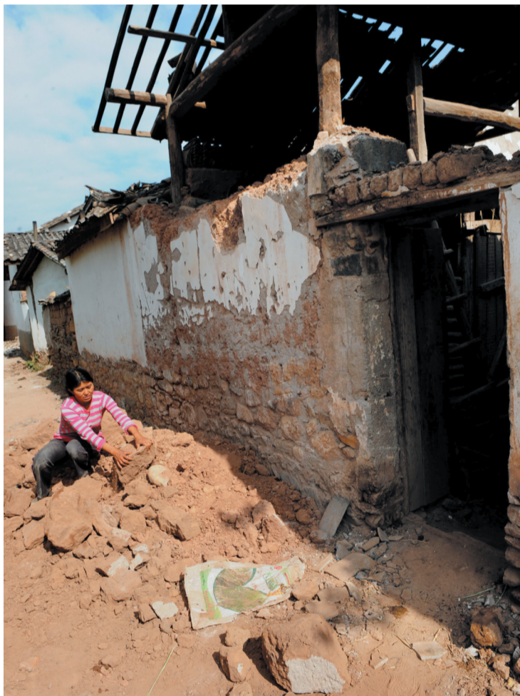
云南大理地震中受损的房屋
