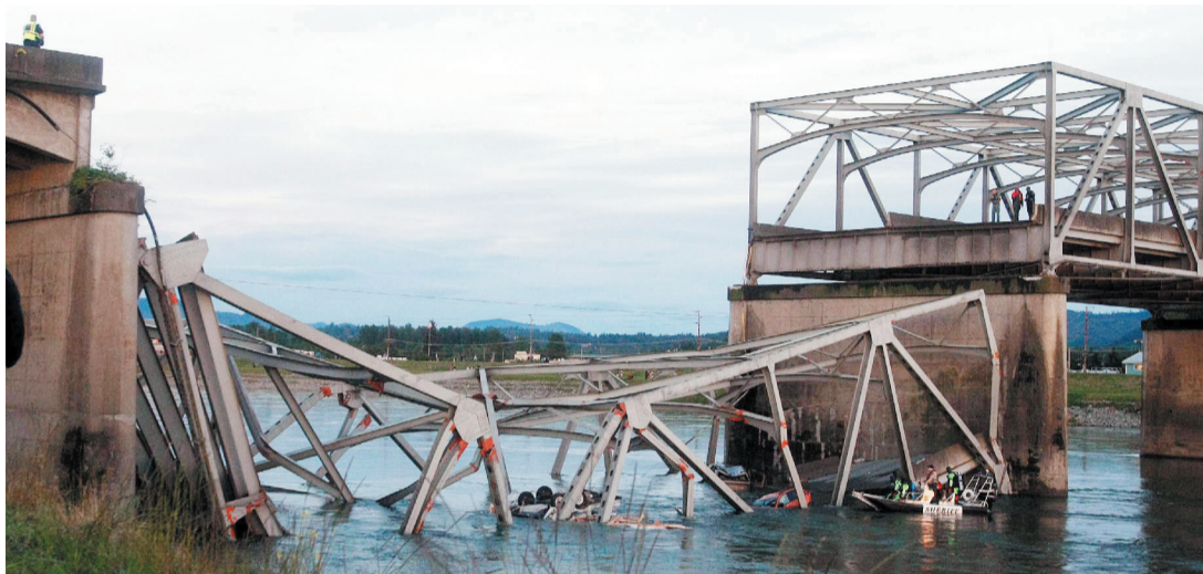
5月23日,在美国华盛顿州芒特弗农,救援人员在垮塌的桥下寻找伤亡者。美国警方23日说,华盛顿州一高速公路桥垮塌,导致多辆汽车和人员掉落水中。目前伤亡情况不详。 据新华社
