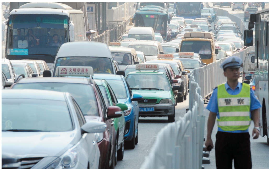
受2号线封闭施工影响,西园路站交通出现拥堵,车辆排起长龙
