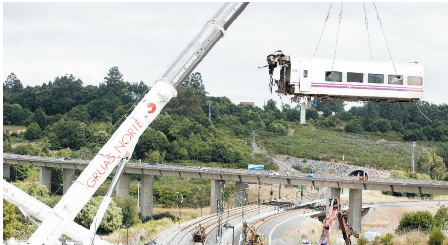
工作人员正在吊起事故车体
