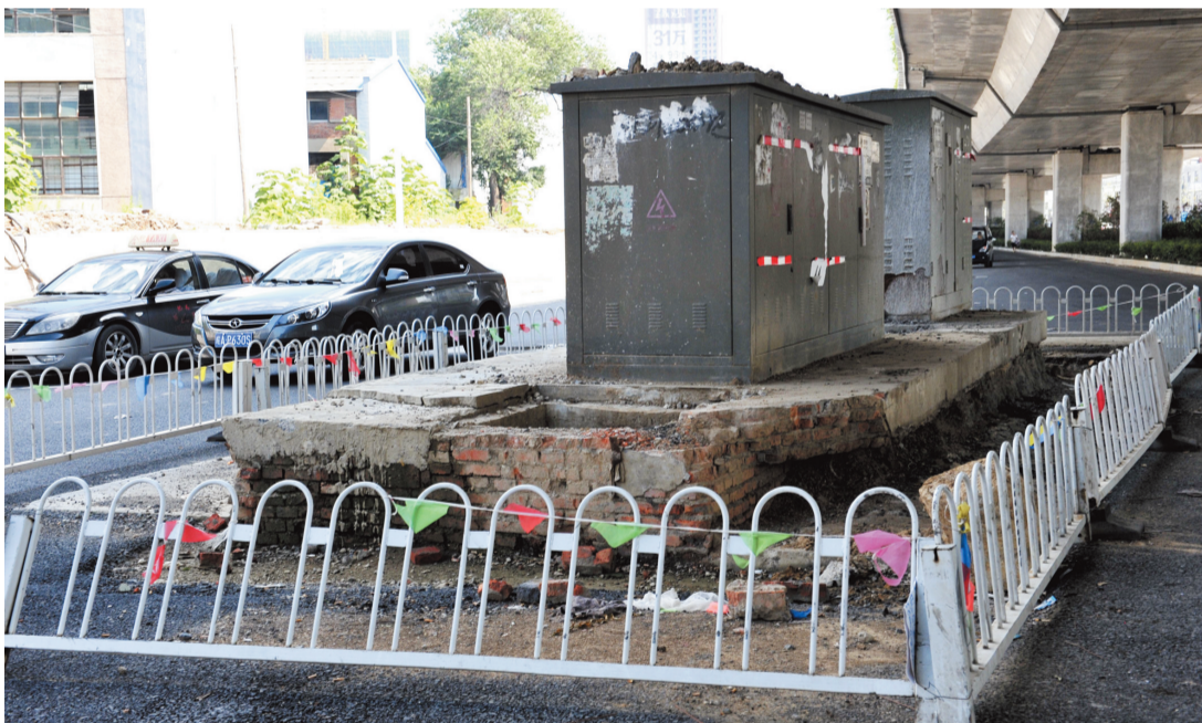
合肥铜陵路高架北段下面已通车一段时间了,可在与长江东大街交口处南北快车道上立着几个电力开关柜,行人车辆到此都要绕行。 记者 倪路/图
