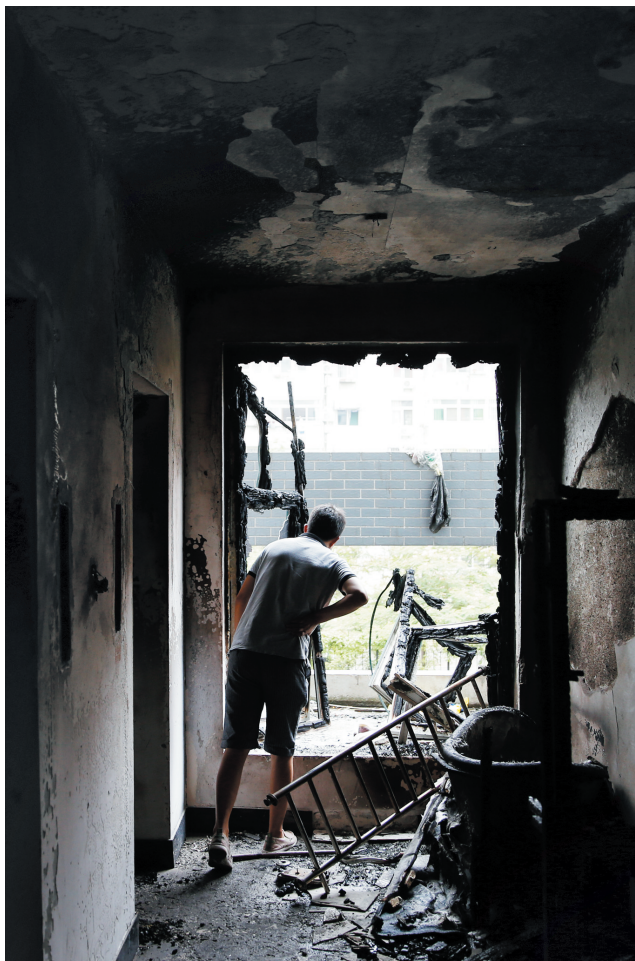
过火后的楼道一片狼藉,两部电梯按键显示屏被烧坏
