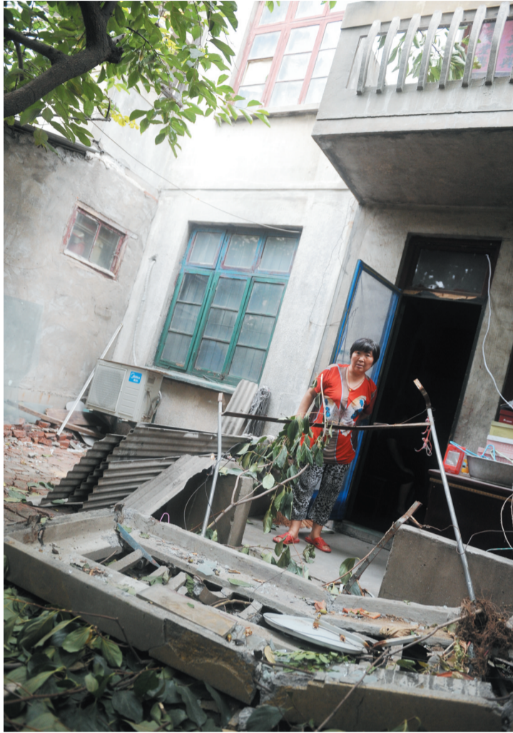
整个三楼阳台围栏都掉落了
